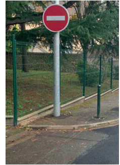
Margelle du trottoir à abaisser pour les PMR.
